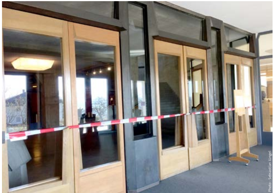
Goetheanum : les portes de l'entrée ouest au premier jour de la fermeture au public.
